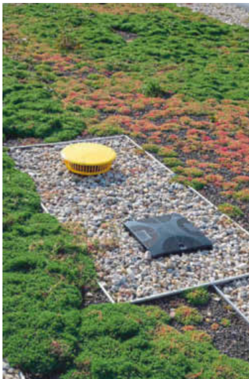
Alle Anschlussbauteile des Retentionsdaches werden für vereinfachte Revision mit Kiesstreifen umgeben.
